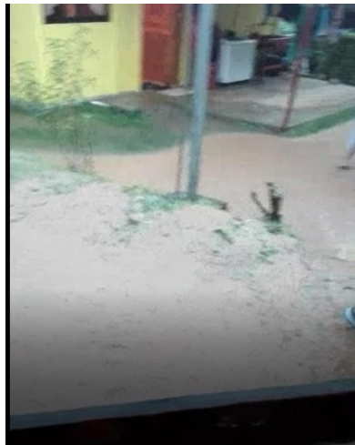
Imagen N°5: afectaciones que tenía la vivienda de Manfred Contreras Sandoval (firmante) antes de los trabajos, se aprecia el agua de desbordada por la servidumbre ingresando a su vivienda.
