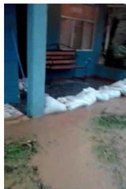
Imagen N°2: afectaciones que tenía la vivienda de Esther Díaz Sojo (firmante) antes de los trabajos, se aprecia la colocación de sacos para evitar que el agua que se desbordaba ingresara.
