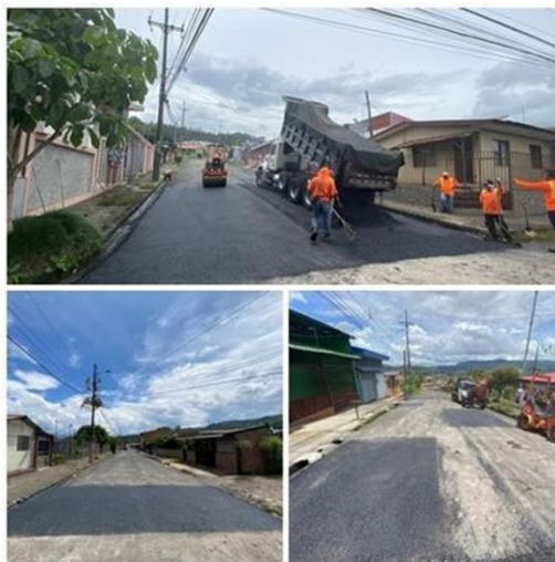
Fotografía N°33: Cuadrantes Turrialba, bacheo formal.
