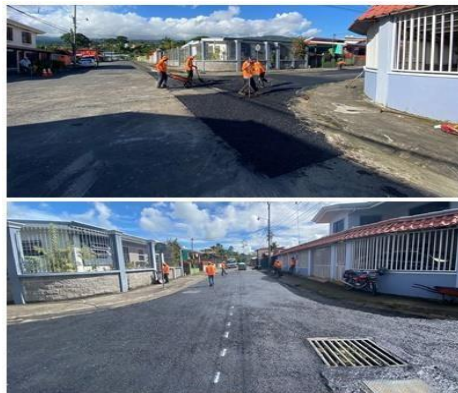
Fotografía N°5: Bacheo formal cuadrantes urbanos Alto Cruz.
