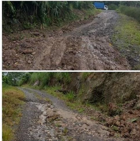
Fotografía N°1: afectación de alcantarilla en el camino San Juan Sur – Murcia.
