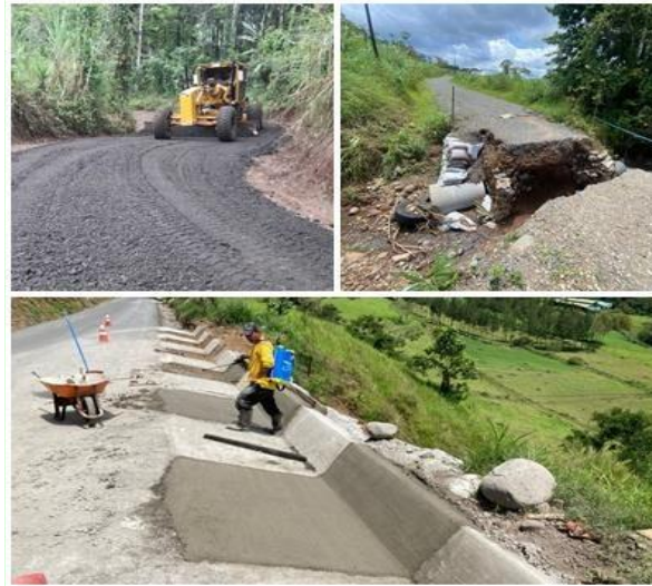
Fotografía N°1: Arriba: Rehabilitación de camino La Flor – El Sol y afectación del camino en San Rafael de Pavones; Abajo: Rehabilitación camino San Antonio Santa Cruz.
