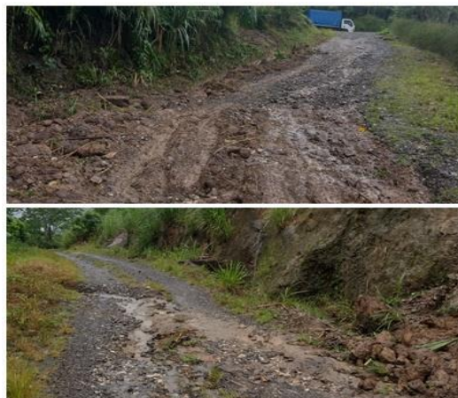
Fotografía N°1: afectación de alcantarilla en el camino San Juan Sur – Murcia.
