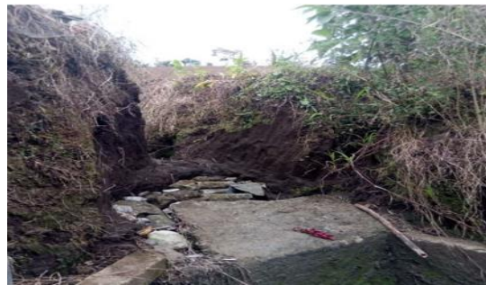
IMAGEN 3: Llegada de aguas pluviales al cabezal en colindancia de la residencia de doña Nora, nótese la socavación (llega a cimentación de la casa)
