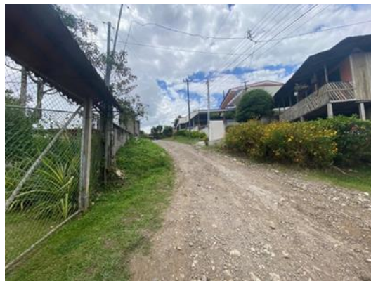
Fotografía N°1: evidencia de falta de aceras y afectaciones al camino público por excavaciones por debajo del nivel de la superficie de rueda.
