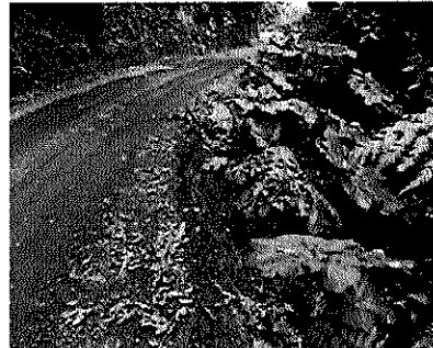
24 Fotografía No.4: Condición identificada 25 km 7+010.
